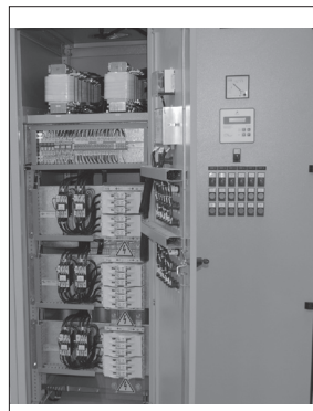
(3) ตัวอย่างตู้ควบคุมคาปาซิเตอร์ ชนิดมีรีแอคเตอร์ หรือ ชนิดดีจูน ตัดต่อโดยใช้คอนแทคเตอร์
