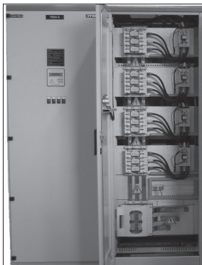
(1) ตัวอย่างตู้คาปาซิเตอร์ ชนิดไม่มีรีแอคเตอร์ ตัดต่อโดยใช้คอนแทคเตอร์
