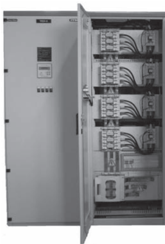
รูปที่ 1 : ตู้คาปาซิเตอร์ 2 ช่อง
